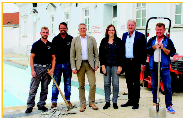
Bademeister Johannes Mayer, Hannes Reindl, Sportbetriebschef Helmut Schneider, Martina Unhaller Verwaltung, Vizebgm. Ing. Alfred Babinsky, Bademeister Alois Melchiort bei Vorbereitungsarbeiten zur Beckensanierung.
